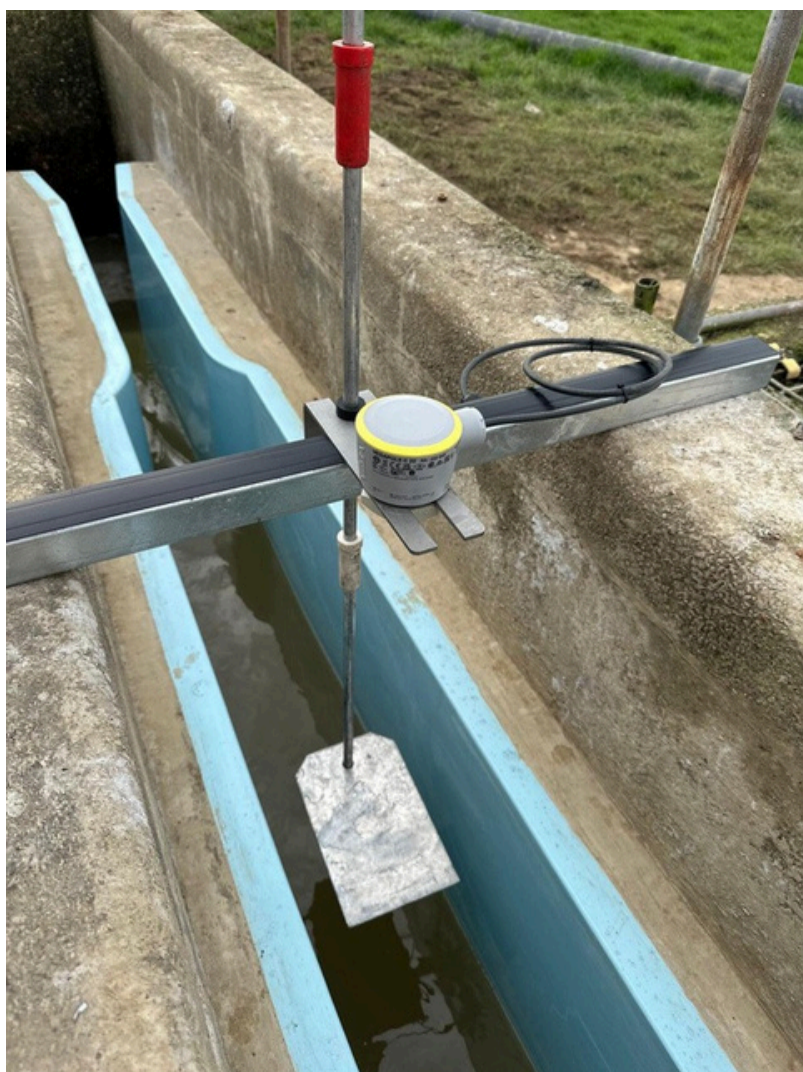
Medición de nivel y caudal en canal Parschall
